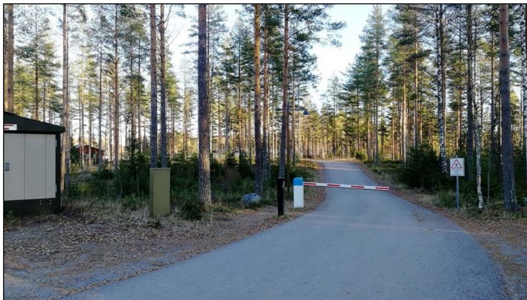
Kuva 2. Rampsintien alkupään puistomuuntamo ja puomi.
