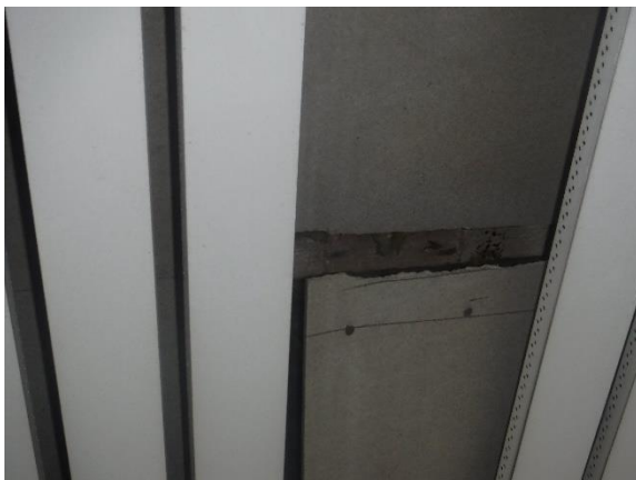
Kovalevytyt, sisäänkäyntikaton pellityksen aluslevy, sisältää yleisesti asbestia
