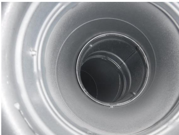
Ilmanvaihtokanavat olivat havaintojen mukaan puhtaita, pölykertymä oli kaikissa tutkimuspisteissä alle 0,7 \text{ g/m}^2
