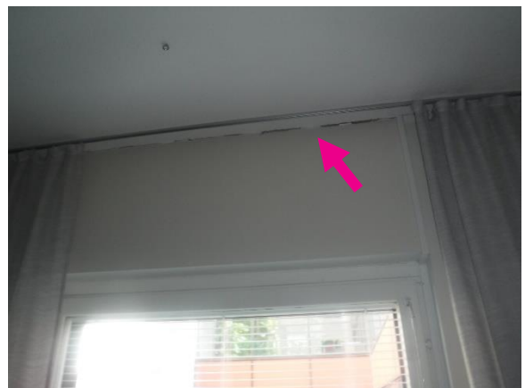
Ulkoseinän ja välipohjan liittymän rakoilua huoneessa 133
