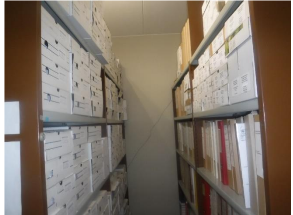
Halkeama varaston väliseinässä
