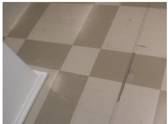
Ensimmäisen kerroksen vinyylilaattapinnassa nähtävissä halkeilua liikuntasauaman kohdalla
