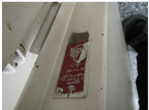
Vanhat palo-ovet saattavat sisältää asbestia
