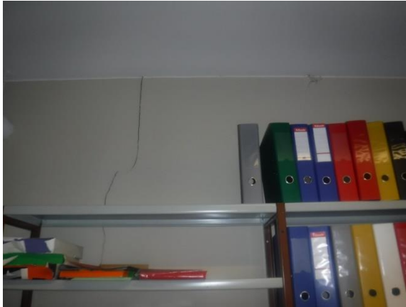
Halkeama varastohuoneen 147 väliseinässä
