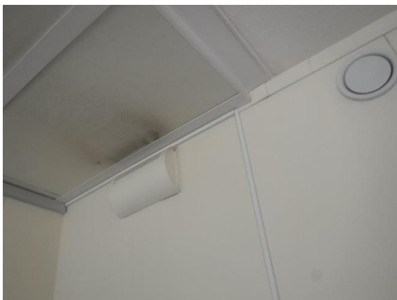
Akustiikkalevyt ovat paikoin tummuneet tuloilman päätelaitteen kohdalla
