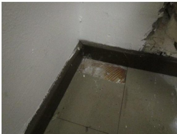
Harmaa vinyylilaatta, liima, tasoite sisältää asbestia (krysotiili)
