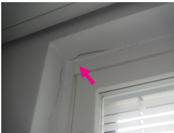
Halkeilua ulkoseinän ja ikkunan liittymässä, 2. kerroksen neuvotteluhuoneessa
