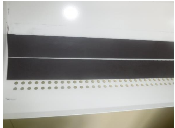
Tuloilmaa oli osittain tukittu tuloilmaventtiileissä
