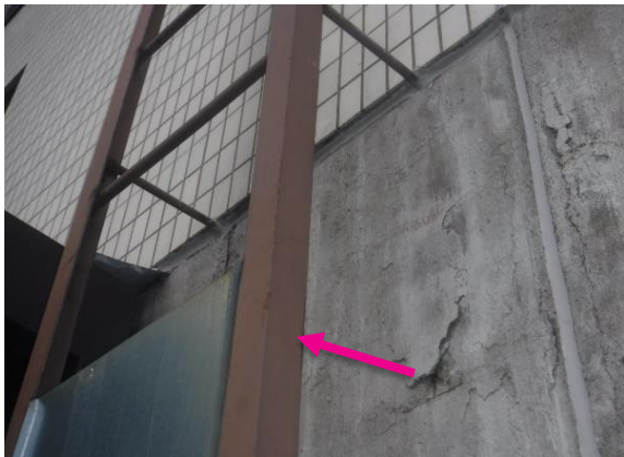
Talotikkaissa on korroosio- ja maalipinnan vau-rioita
