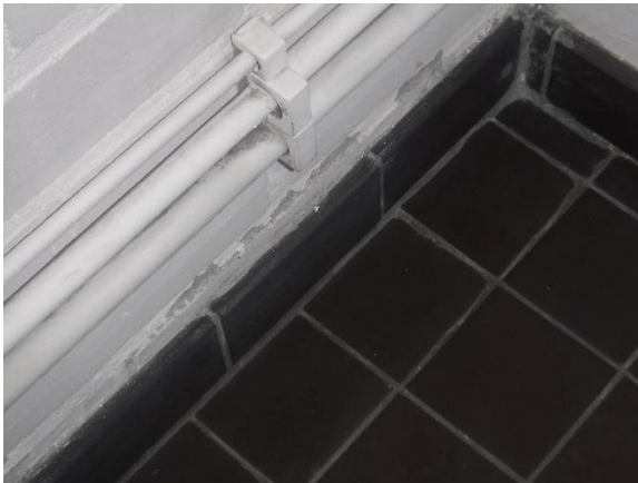
Kosteuden aiheuttamaa maalin hilseilyä märkätälässä
