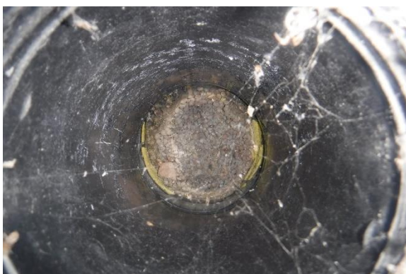
Yläpohja tuulettuu tuuletusputkien kautta heikommin
