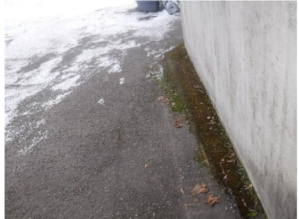
Sammalkasvustoa, joka indikoi kallistuksen puutteista
