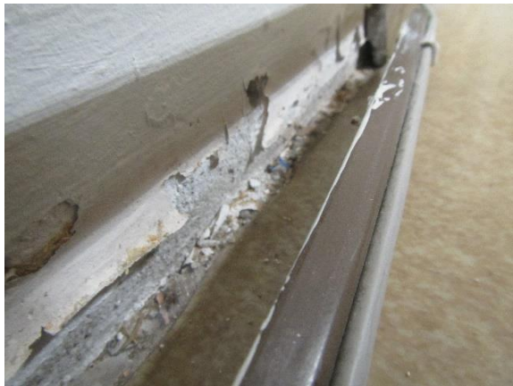
Kosteusvauriojälkiä seinän alareunassa
