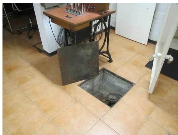
Väestönsuojan uusittua laattalattiaa, lattialuukusta nousee maakellarimainen haju
