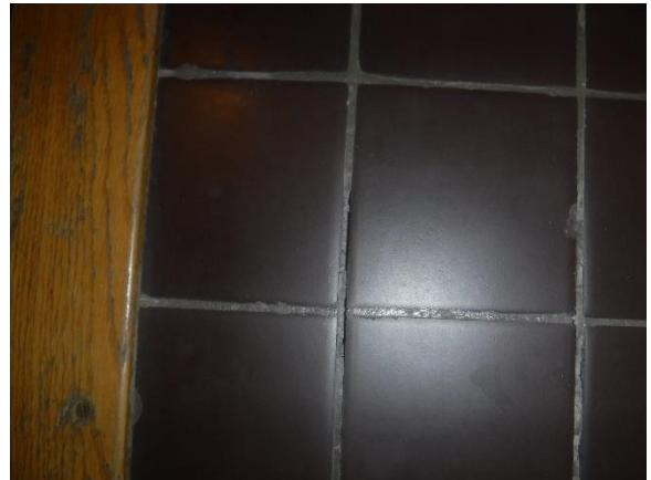
Märkätilojen lattialaattojen saumoja on paikoin auki
