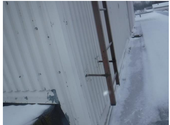
Talotikkaissa on korroosioaurioita
