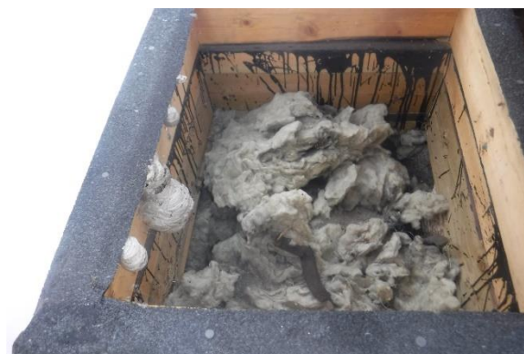
Yläpohjan tarkastusluukut oli laitettu umpeen mineraalivillalla, luukuissa oli ampiaispesiä
