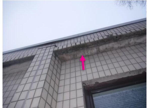
Julkisivun ulkonevan vaakaosan alapinnassa kosteusjälkiä
