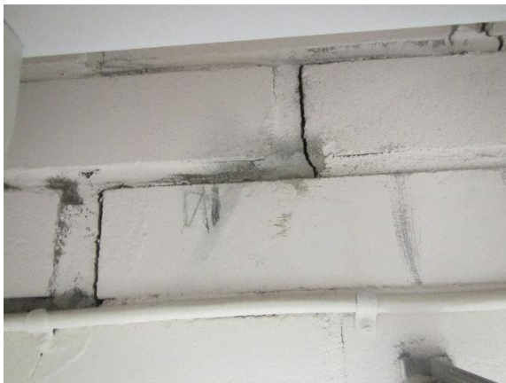
Tiiliväliseinissä on paikallisia halkeamia, ilmavuotoa
