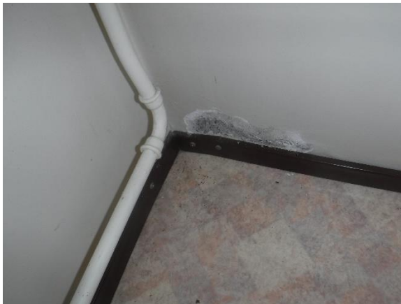
Merkkejä kosteusvauriosta kellarikerroksen ulkoseinässä
