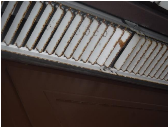
Sisääntulokatoksen ritiläpellityksessä on korroosioaurioita
