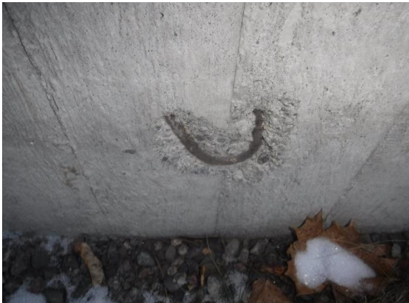
Yksittäinen paljastunut raudoite
