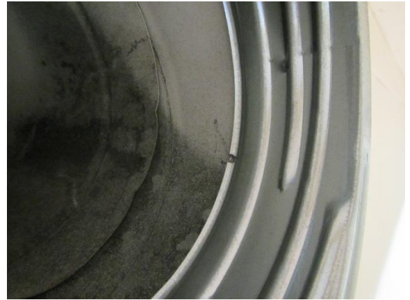
Tuloilmakanavissa on paikoin paljon pölyä
