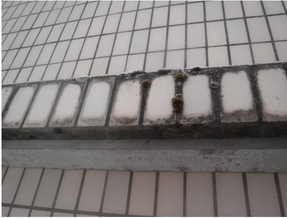
Kosteusjälkiä ja kasvustoja on etenkin puiden kohdalla
