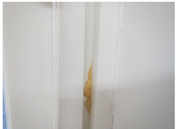
Uusittujen ikkunoiden karmieristeenä on polyuretaani, paikoin viimeistelyssä puutteita
