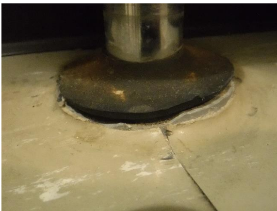
Viemäriputkien läpivienneissä on rakoilua ja tiivisteet ovat ikääntyneet
