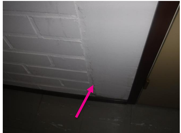
Rako betoni- ja tiiliseinärajapinnassa
