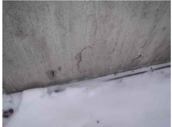
Pinnoittamattomissa julkisivuelementeissä havaittiin yleisesti raudoitteiden korroosioaurioista aiheutuneita betonin lohkeamia, halkeamia ja paljastuneita raudoitteita
