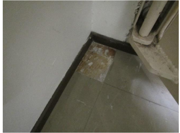
Vinyylilaatan liimapinnalla on paikoin liimapinnan vaurioita
