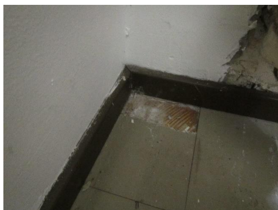
HA.05 Harmaa vinyylilaatta, liima, tasoite sisältää asbestia (krysotiili)
