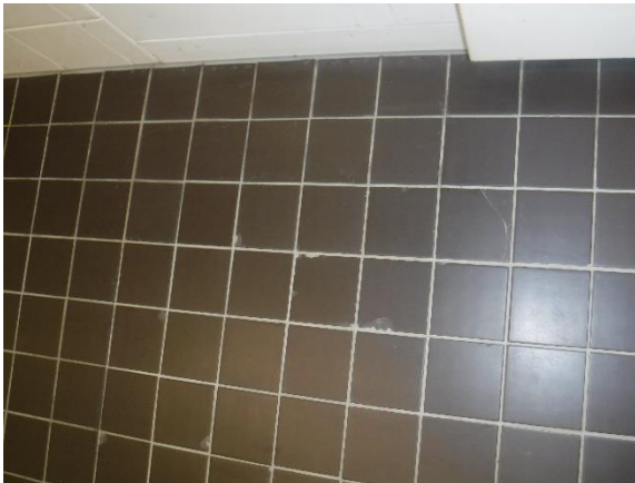
Märkätilojen lattialaatat irti alustasta paikallisesti
