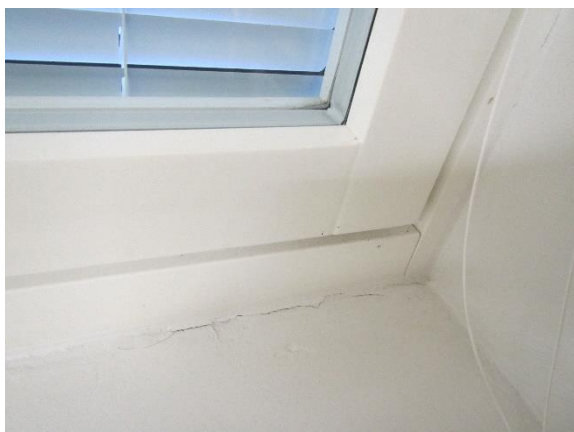
Ikkunan ja seinän liittymässä paikallisesti rakoilua
