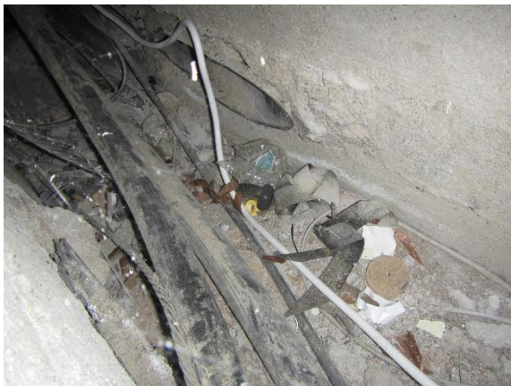
Sähköpääkeskuksesta lähtevä kaapelikanaali on täynnä roskaa, tiivistämätön aukko
