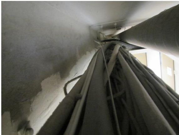
Pölyisiä kaapelihyllyjä huonetiloissa
