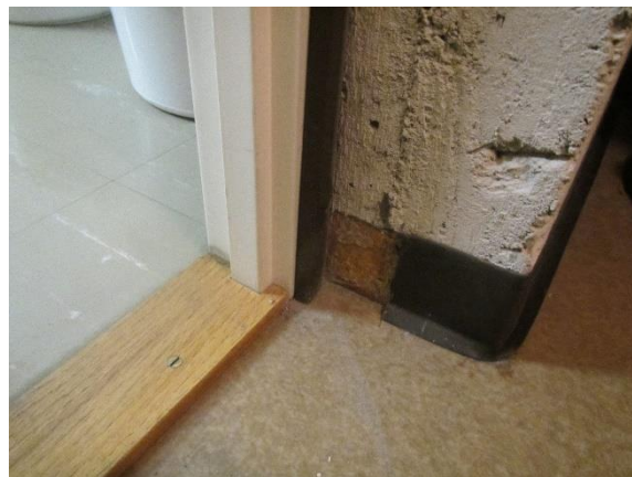
Tummanruskeassa muovisessa jalkalistassa (HA.04) havaittiin lyijyä yli ylempien ohjearvojen
