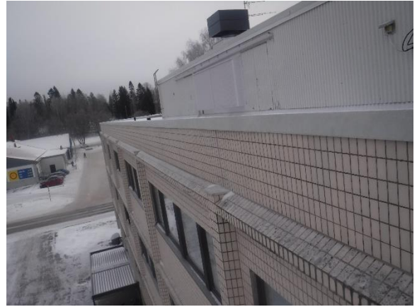
Kosteusjälkiä ja kasvustoja on yleisesti
