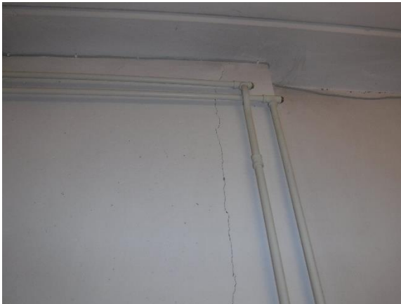
Yksittäinen halkeama seinässä
