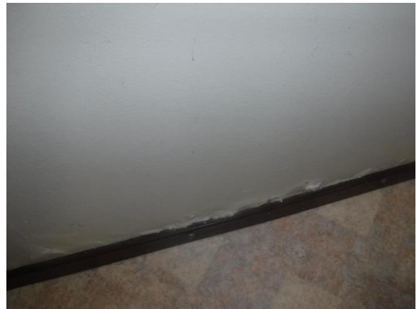
Merkkejä kosteusvauriosta kellarikerroksen ulkoseinässä
