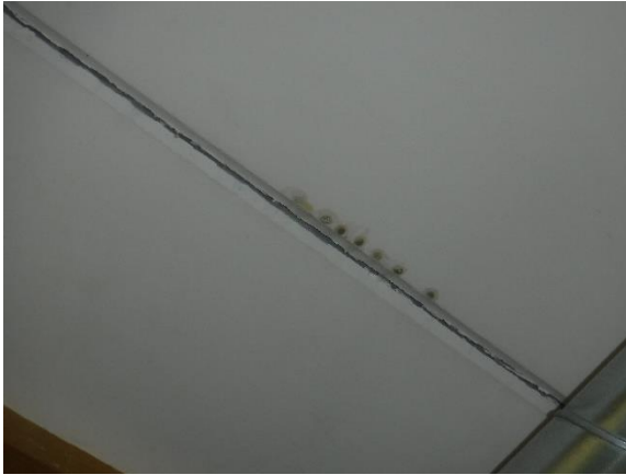
Välipohjan saumoissa on rakoilua ja vesivuotojälkiä, jotka havaintojen mukaan ovat vanhoja
