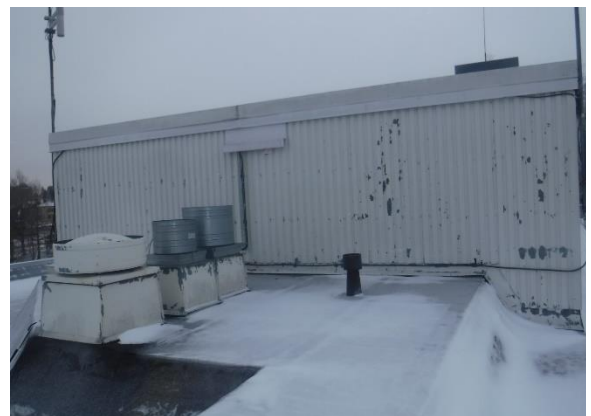
IV-konehuoneen seinien pellityksen maalipinta hilseilee
