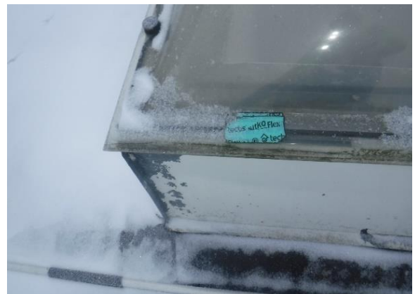
Kattoikkunaa on paikattu teipillä, pellityksen maalipinta hilseilee
