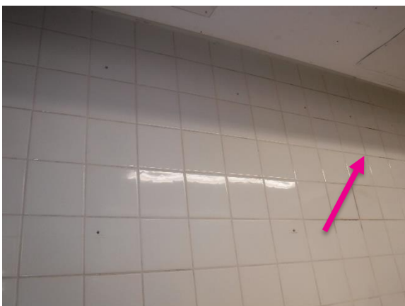
Saumauspuutteita keittiön laattaseinissä
