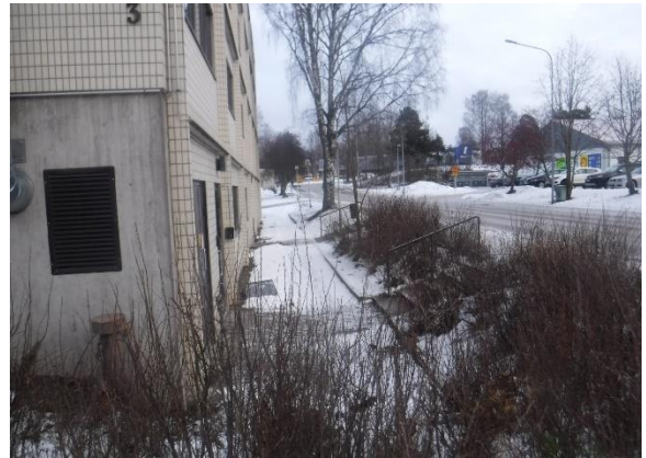
Maanpinta viettää paikoin kohti rakennusta ja rakennuksen vierellä on kosteutta pidättävää kasvillisuutta
