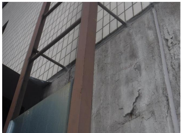
Korroosioaurioita betoniteräksissä aiheuttaen betonin lohkeamisen
