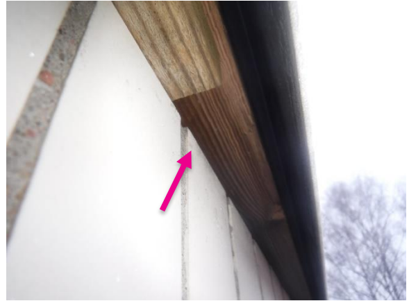
Ilman myrskypeltiä voi sadevesi kulkeutua eristetilaan, pieneläinverkkoa ei havaittu
