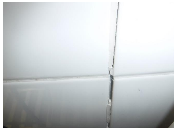
Keittiön seinälaatoituksen saumauksissa on paikoin puutteita
