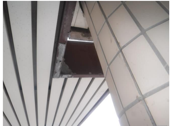
Pellityksen maalipinta irtoilee
