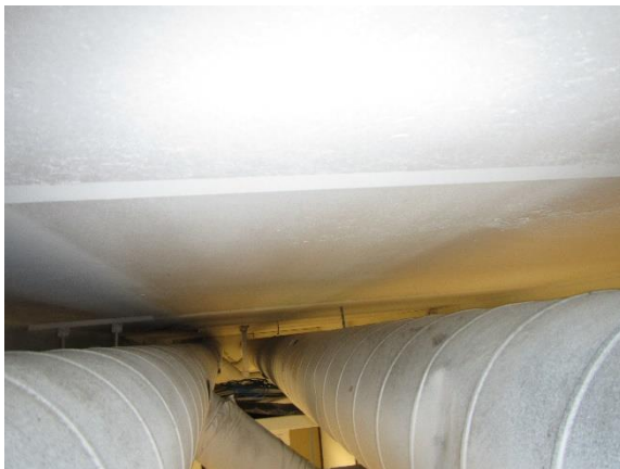
Pölyisiä putkistojen yläpuolia huonetiloissa
