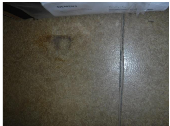
Muovimaton sauma rakoilee ja muovimatossa värjäytymää ja kuluneisuutta
