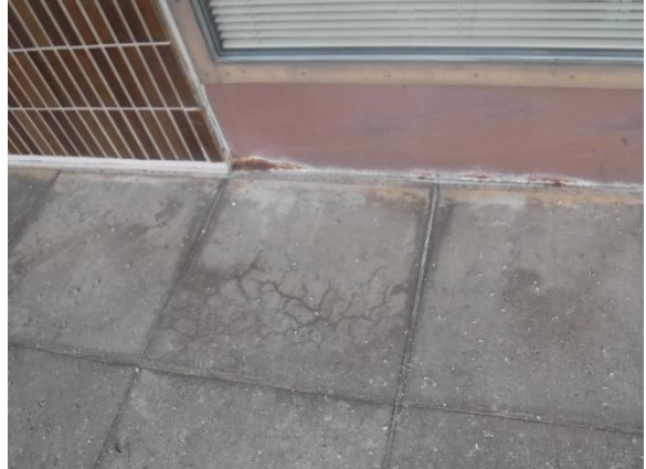
Korroosioaurioita metallilevyssä ja rako kitauksessa
