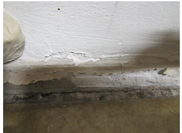
Kosteusvauriojälkiä ja rakoilua seinän ja alapohjan liittymässä
