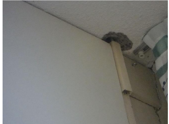
Tiivistämätön läpivienti välipohjan läpi
