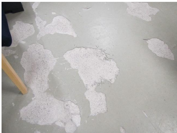
Väestösuojan vihertävässä lattiamaalipinnoitteessa (HA.10) havaittiin raskasmetallipitoisuuksia yli ylempien ohjearvojen (arseeni, lyijy, sinkki, vanadiini)
