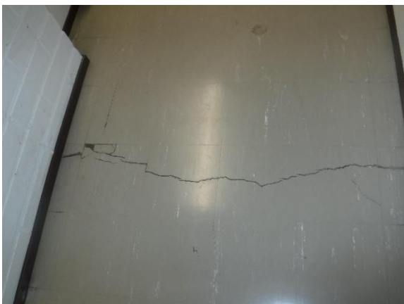
Alapohjan vinyylilaattapinta halkeilee yleisesti eri puolilla rakennusta
