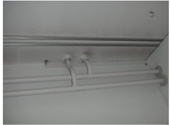
Tiivistämättömiä läpivientejä, hallitsematonta ilmavuotoa
