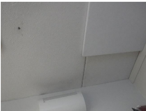
Halkeilua välipohjan laatoissa
