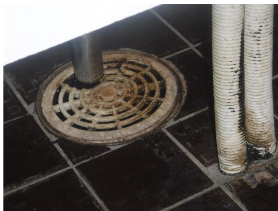
Lattiakaivossa ja läpivienneissä pinttynyttä likaa ja mikrobikasvustoja
