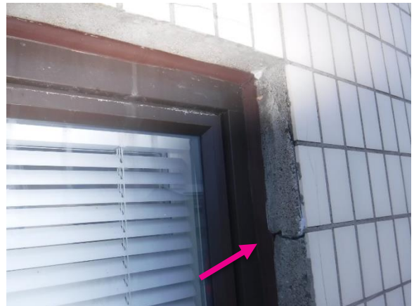
Yksittäinen suurempi halkeama ikkunapielessä
