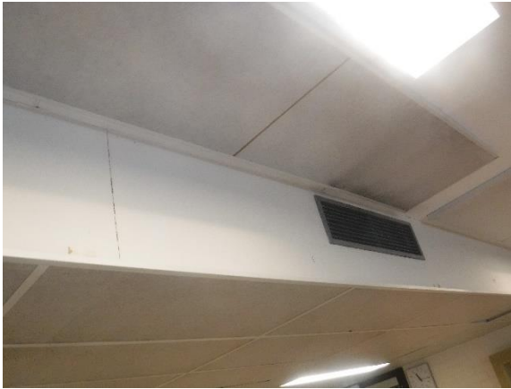
Akustiikkalevyjen pinnoilla on paikoin pölyä
