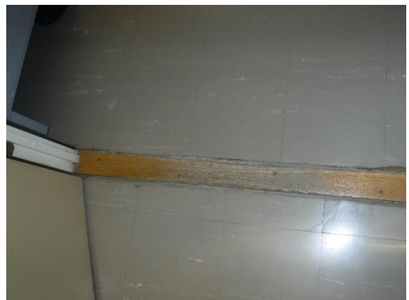
Alapohjan vinyylilaattapinnan liittymä rakoilee kynnyksen juuressa, vinyylilaattapinnalla kuluneisuutta
