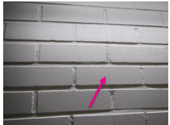
Pitkä halkeama tiiliseinässä
