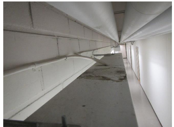
Pölyisiä valaisimien yläpuolia käytävällä
