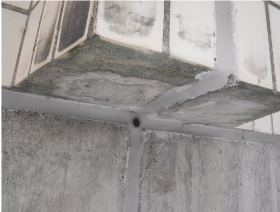
Kosteusjälkiä "pilasterin" alareunassa
