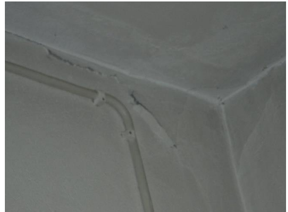
Maali hilseilee seinässä ja hallitsematonta ilmavuotoa
