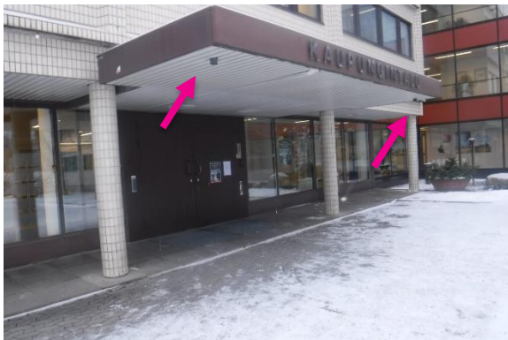
Sisäänkäynnin katoksen vedenohjaus on putkella pihalle, joka voi tehdä pihan liukkaaksi
