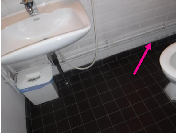
Kosteuden aiheuttamia jälkiä
