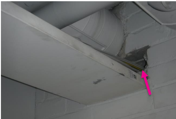
Palokatkot puuttuvat mahdollisesti osastoivista väliseinistä
