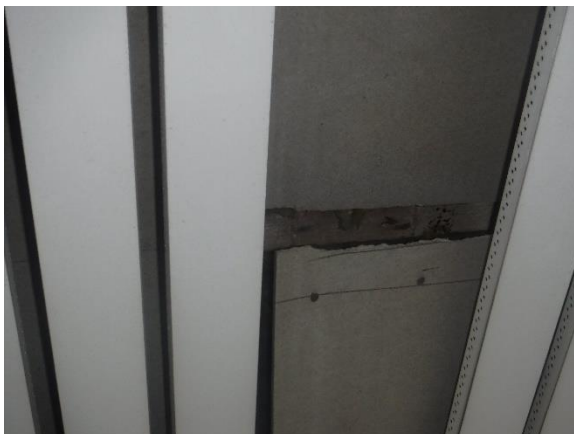
Kovalevytyks, sisäänkäyntikatoksen pellityksen aluslevy, sisältää yleisesti asbestia
