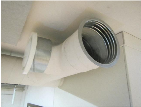
Tuloilmakanavia ei ole nuohottu lähivuosina
