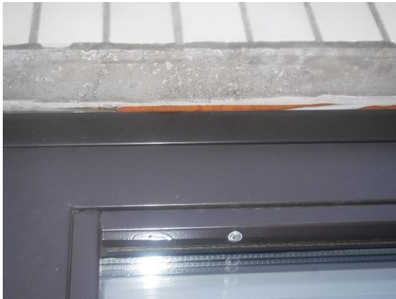
Yksittäisen ulko-oven listoitus/reunatiivistys on jäänyt puutteelliseksi
