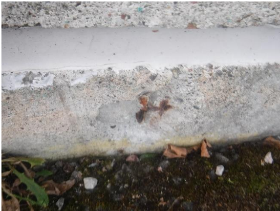
Korroosioaurio sokkelibetonin teräksessä
