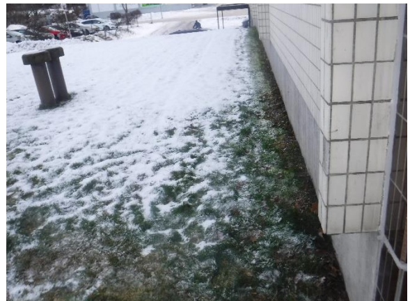
Nurmialue ulottuu perusmuurin asti, josta aiheutuu rakenteille ylimääräistä kosteusrasitusta
