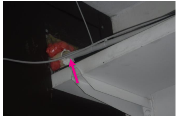
Palo-oven yläosassa ei ole asianmukaista palokatkoa
