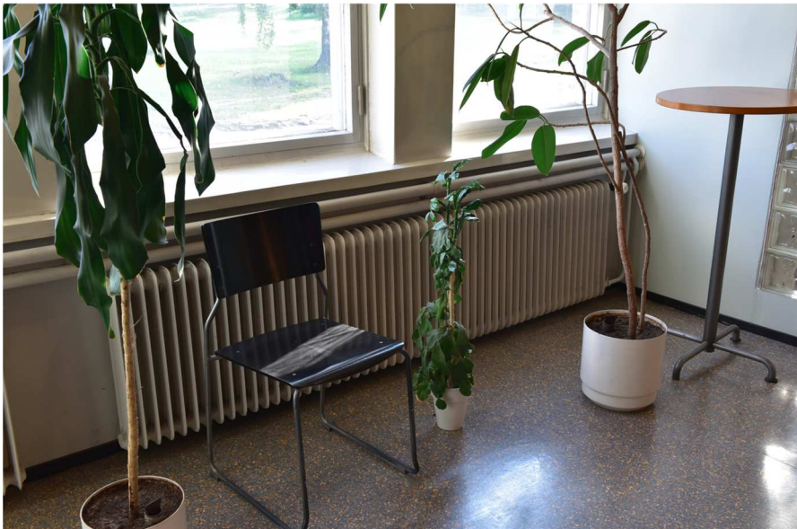
Kuva: Erolan lounasravintolan eteistilaa. Tehtaan ikkunat ovat pääasiassa vanhoja. Ikkunan alla on pinta-asennettu Högforsin Kesto-radiaattori.
