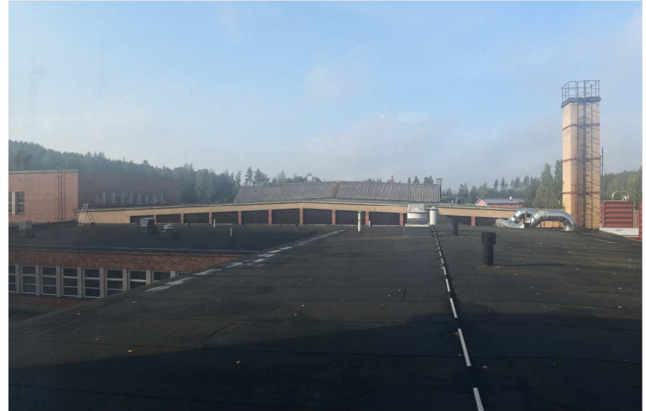
Kuva: Tehtaan matalan konttorisiiven ja vanhimman tehdashallin katot ja savupiippu. Päädyn ikkuna-aukkoihin on äskettäin asennettu levyt.
