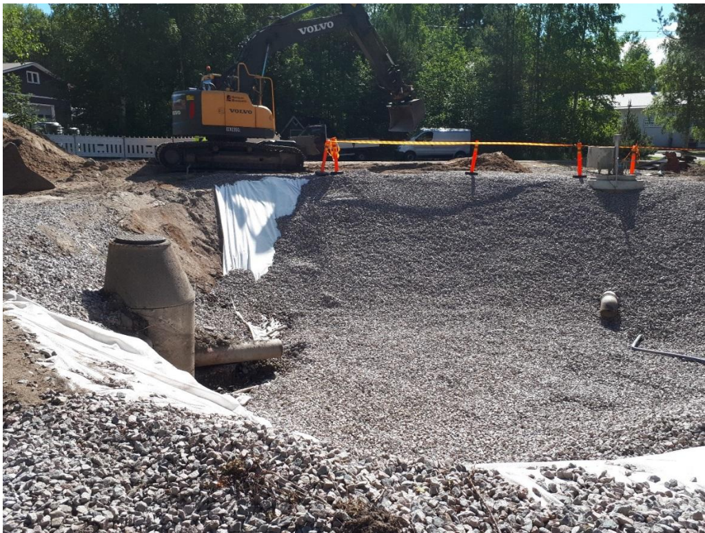
Kuva 4-2. Hulevesipumppaamon tasausallas keväällä 2018.
