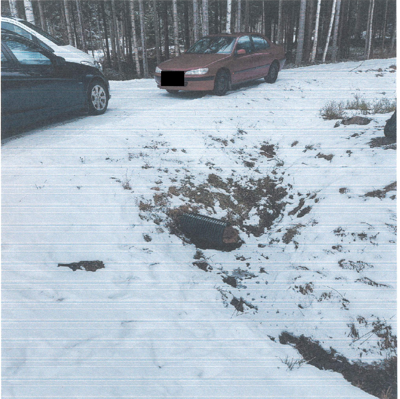
Kuva 3. Itäpirtintien alittava rumpuputki oli katselmushetkellä tukittuna isolla kivellä
