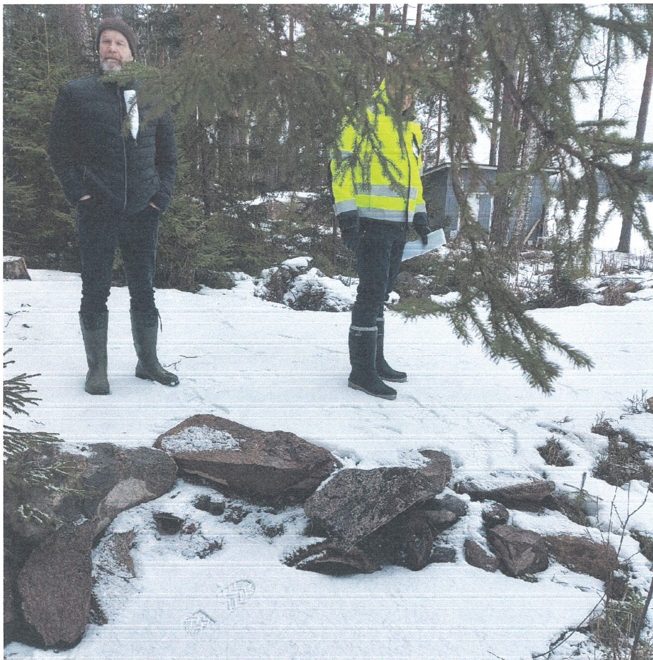
Kuva 4. Vanha betoninen rumpu joka on jäänyt umpeen. Vanha rumpuputki on poisto-ohjelmassa pihatien rakennekerroksien uusimistöiden yhteydessä. Tonttien rajalinjalla on luonteva painanne hulevesien virtaamiselle vesistöön.
