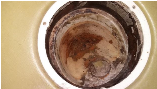
Kuva 7 Vanha valurautakaivo, pohja ruostunut ja kiristysrenkas ei tiiviistä maton ja kaivon liittymää
