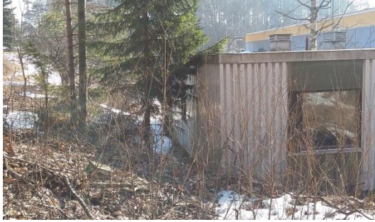
Kuva 5 Puutteellinen pintavesien ohjaus
