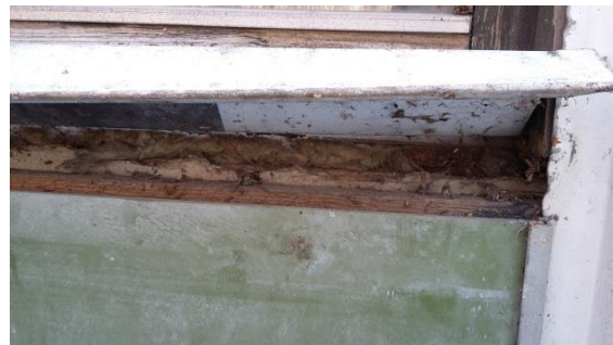
Kuva 4 Ikkunapellit huitaistu kiinni ja vesi pääsee liittymistä ulkoseinärakenteeseen.
