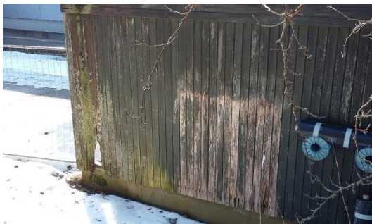
Kuva 3 Ravistunutta ja osin lahonnutta panelointia
