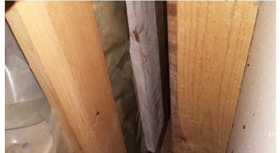
Kuva 6 Puutteellinen höyrinsulku katos- sa ja kosteusjälkiä muovin päällä.
